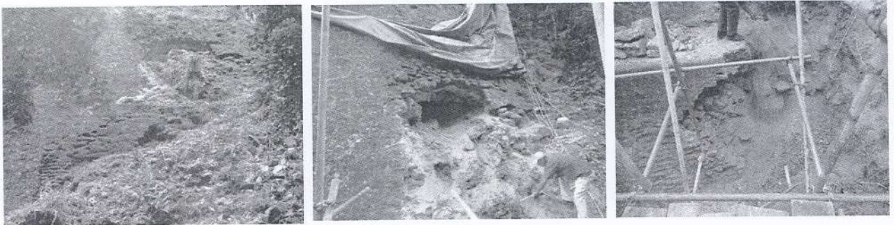
Foto No 1, 2 y 3, Limpieza en área colapsada de segundo cuerpo, fachada oeste Templo V
